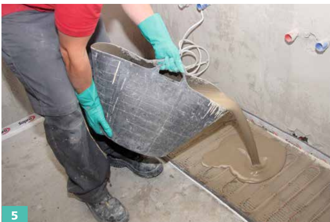
5 Auch die Sopro Elektro-Fußbodenheizung mit Sopro FS 15® plus überarbeiten und in die Ausgleichsschicht einbetten.
