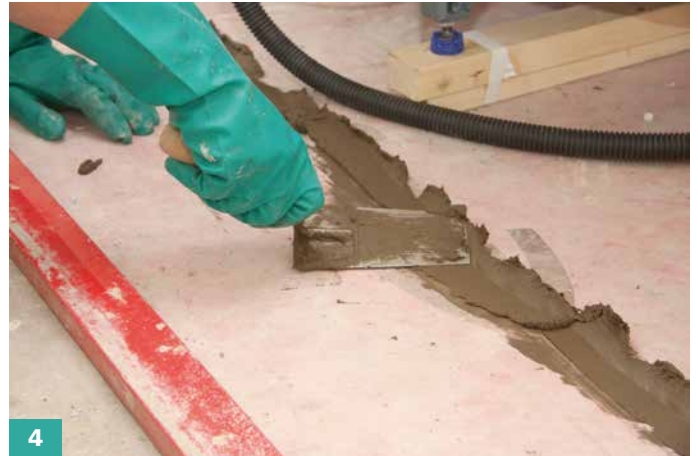
4 ... als auch den angrenzenden Bodenbereich ...
