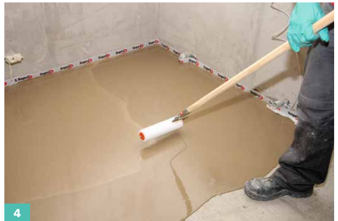
4 Durch den Einsatz einer Stachelwalze wird die Spachtelmasse entlüftet und die Verlaufeigenschaften unterstützt.
